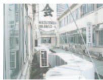
fig.1築地のダクト
